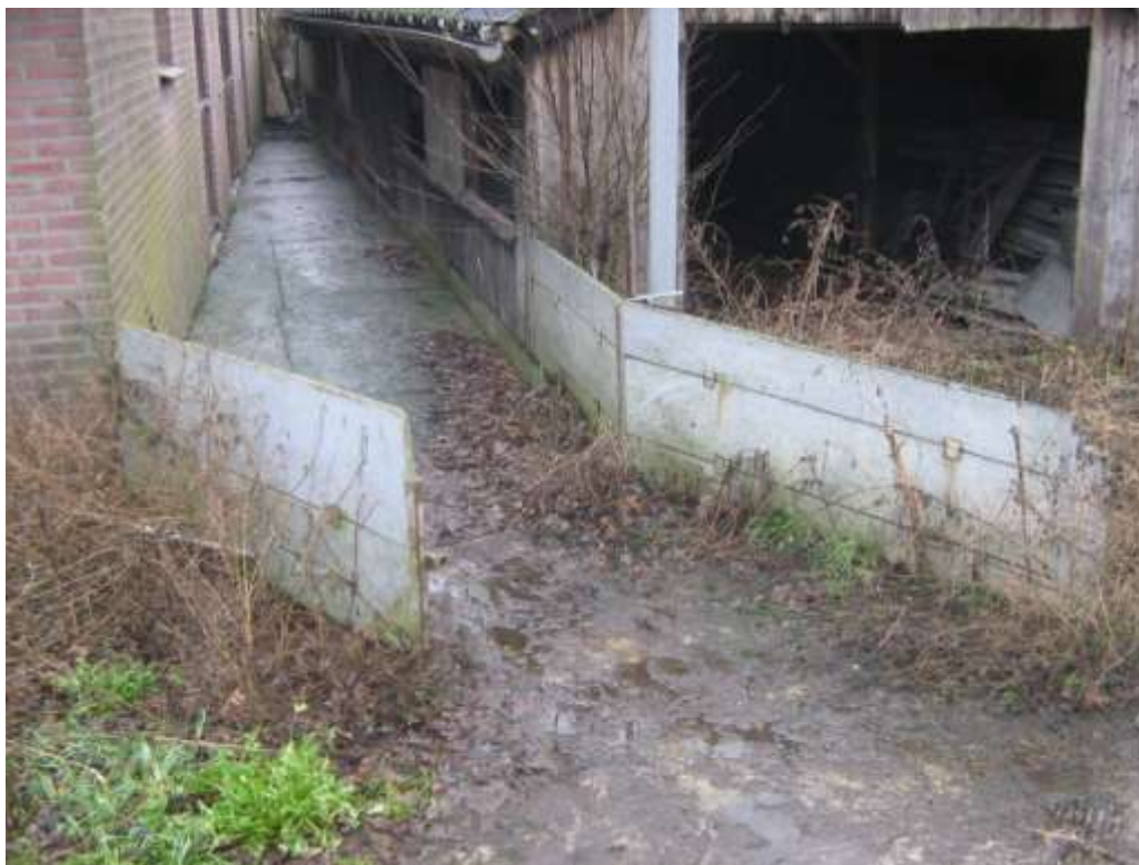
Foto 3: Asbestverdachte schotten (zie bijlage 2a).
