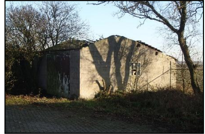
Figuur 11. Vervallen schuur.
