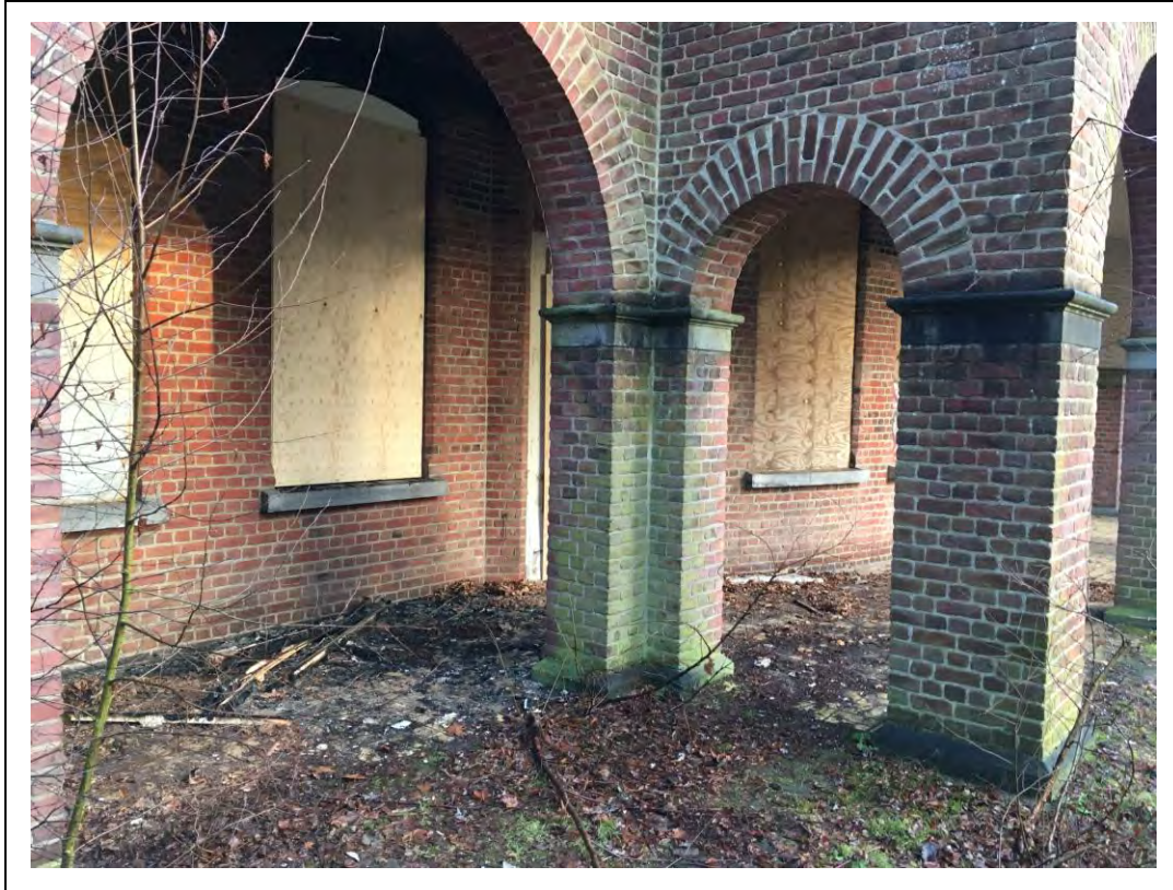
Foto 19. Gebouw brand december 2016
