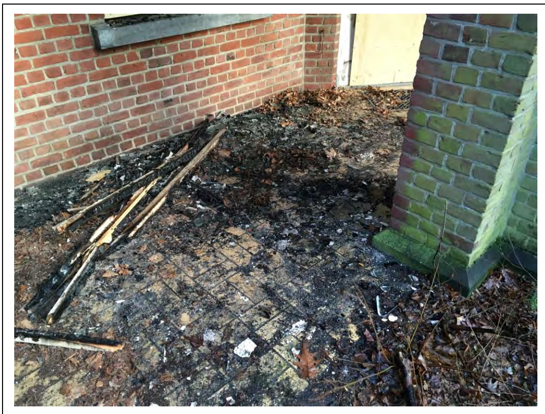
Foto 20. Gebouw brand december 2016
