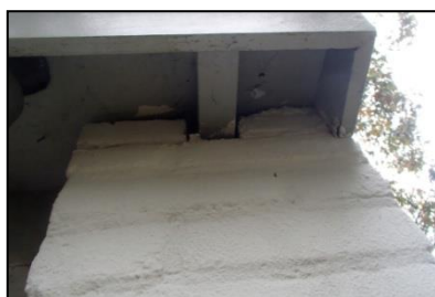
Figuur 10. Losliggende bakstenen onder dakrand
