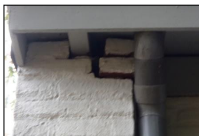
Figuur 11. Losliggende bakstenen onder dakrand
