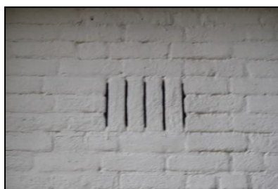
Figuur 9. Ontluchtingsgaten die toegang tot de spouwmuur bieden.
