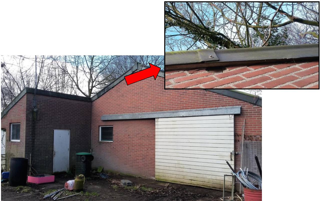
Figuur 5. Onder de boeiboord is een houten plank aanwezig, zodat hier geen ruimte is voor vogelnesten of vleermuisverblijven.
