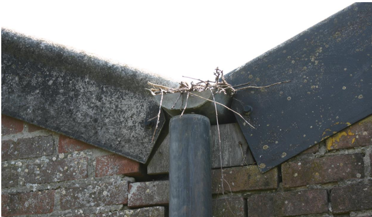
Figuur 5. Oud kauwennest in een van de dakgoten tussen de stallen.
