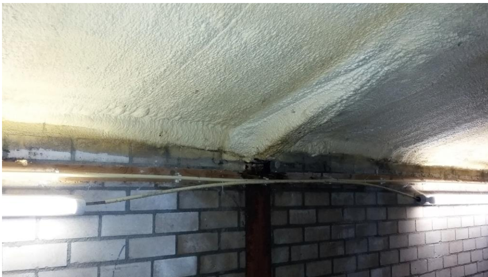
Figuur 8. Van binnen is het dak afgewerkt met schuim.
