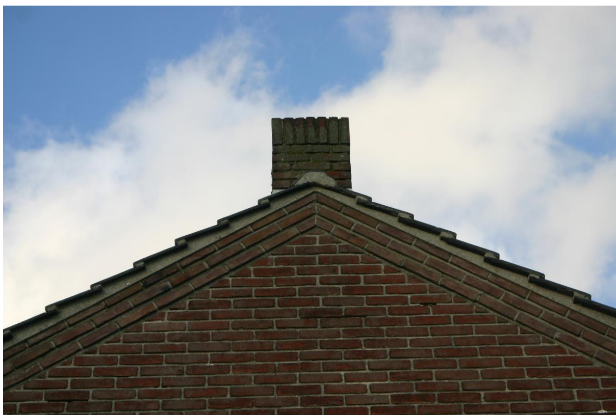
Figuur 4.2.2. De gevelpannen zijn afgestreken met specie. Hierdoor is er geen toegang voor gierzwaluwen of vleermuizen tot de te slopen woning.
