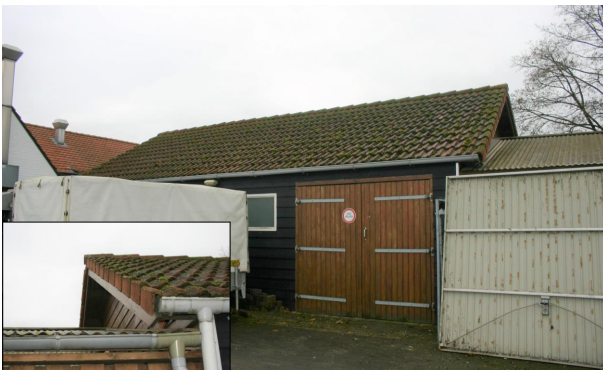
Figuur 4.2.2. De garage heeft alleen openingen onder de overstekende gevelpannen. Omdat zich direct hieronder overkappingen (aan weerszijden; zie inzet) bevinden, is het niet mogelijk voor gierzwaluwen en vleermuizen om hier in te vliegen.
