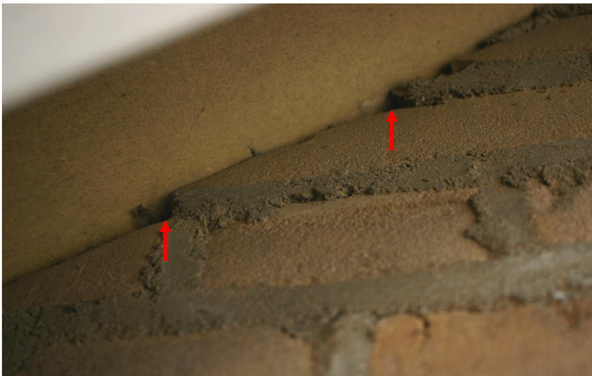
Figuur 4.2.1. Tussen de gevel en het dakbeschot zijn meerdere openingen waardoor vleermuizen de woning binnen kunnen.
