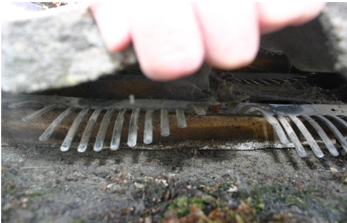
Figuur 4.2.3. Onder de onderste rij dakpannen is degelijk vogelschroot aanwezig.
