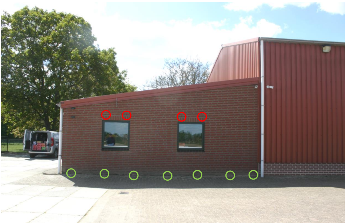
Figuur 4.2.2. In de kantine (aan de zuidelijk gelegen loods) zijn meerdere open stootvoegen aanwezig die zowel vleermuizen (rode cirkels) als kleine, grondgebonden zoogdieren (groene cirkels) toegang geven tot de spouw.
