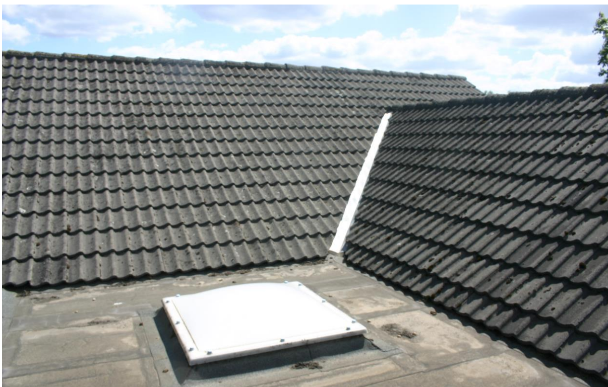
Figuur 4.2.4. De onderste rij dakpannen van de woning is door de ligging van het platte dak gemakkelijk bereikbaar voor predatoren. Ook zijdes van het dak die niet aan het platte dak grenzen, zijn goed bereikbaar.
