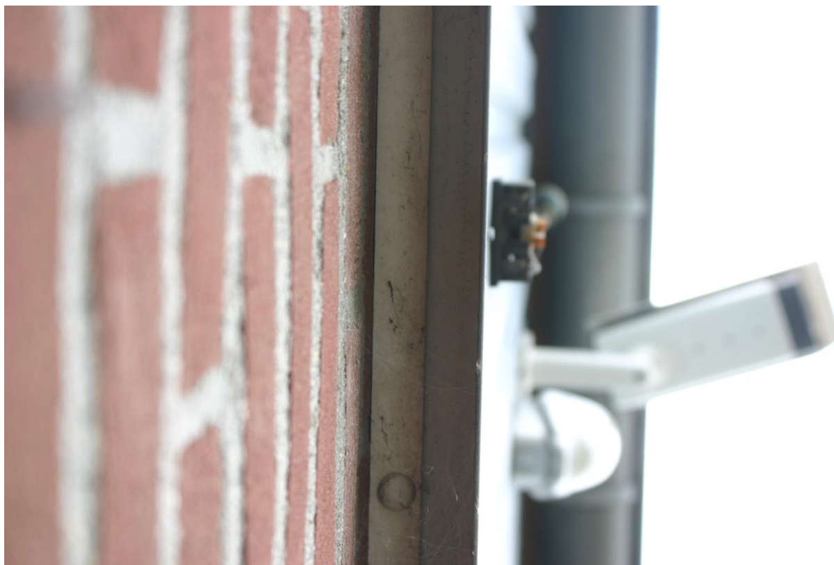
Figuur 4.2.1. De ruimte tussen de damwand en de spouw van de loods is overal afgedicht en daardoor niet bereikbaar voor vleermuizen.
