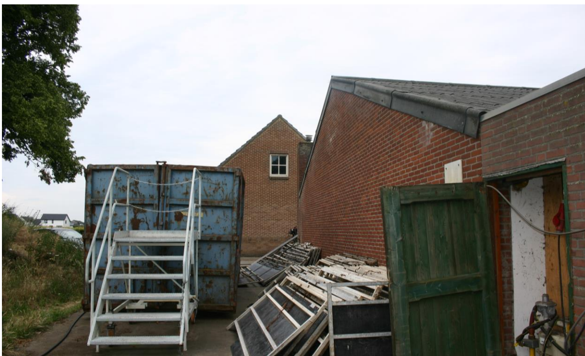
Figuur 4.2.2. De kopse kanten van de zuidelijke varkensstal hebben overstekende golfplaten. De ruimte tussen deze golfplaten en de spouw is afgedicht met een lat.
