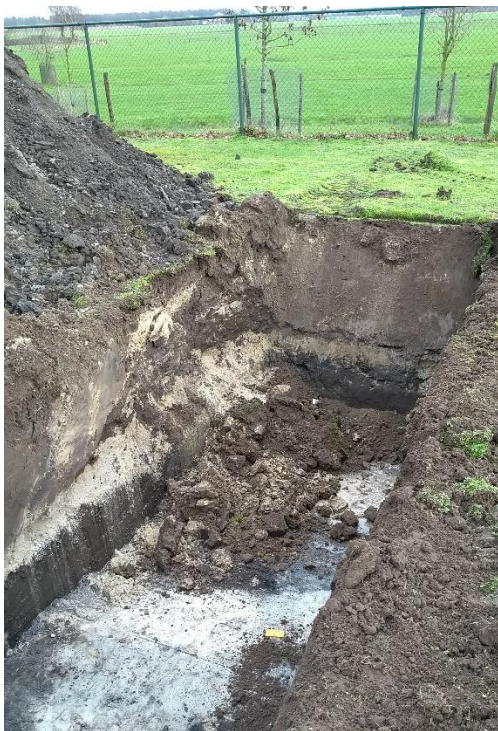
Figuur 3. De ingestorte wand van sleuf 2.
