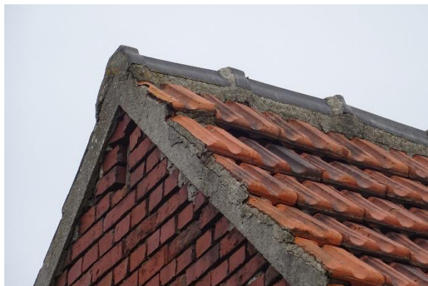
Afbeelding 7: Door de aangesmeerde dakpannen/nokpannen kunnen vleermuizen hier niet onder het dak komen. Bron: Rik Bijvelds, datum: 18-02-2021
