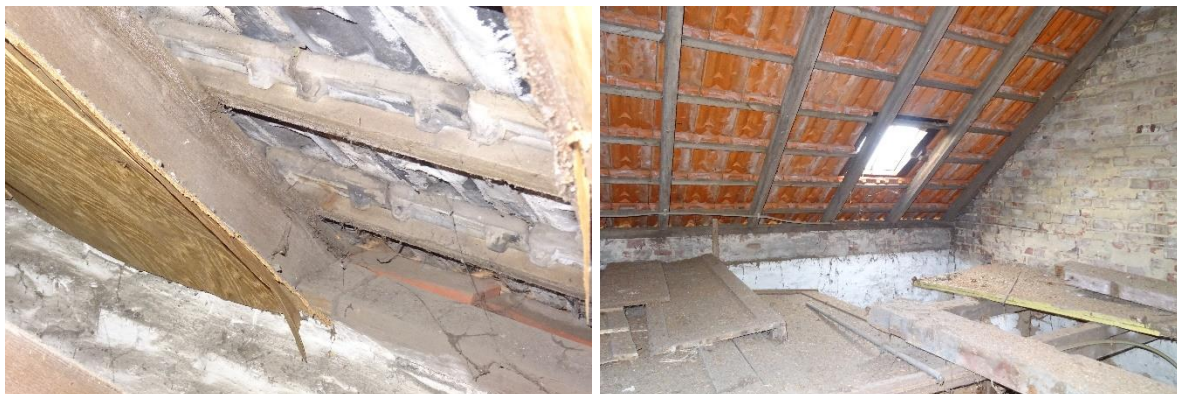
Afbeelding 5 en 6: Dak grotendeels zonder dakbeschot en minimale openingen tussen dakpannen waar huismussen binnen kunnen komen/ kunnen verblijven. Bron: Rik Bijvelds, datum: 18-02-2021
