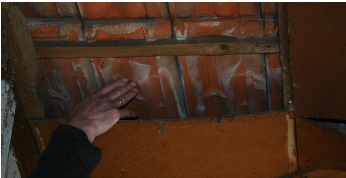
Figuur 4.4.2. De ruimte tussen de dakpannen en het dakbeschot is zeer ruim en daardoor te tochtig voor vleermuizen.
