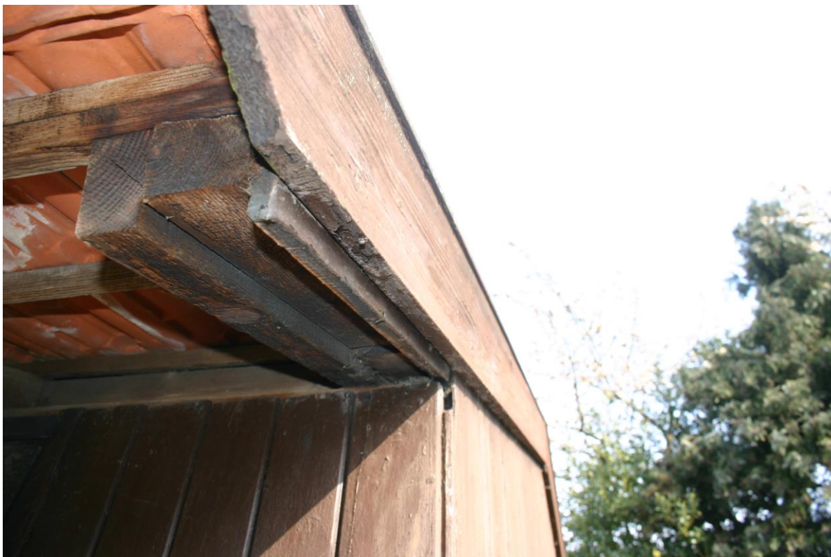
Figuur 4.4.3. Tussen de panlat op de zijgevel en de dakpan erboven is onvoldoende ruimte om vogels toegang te verlenen tot het dak. Tussen de windveer en de kopgevel is verder onvoldoende ruimte aanwezig om als toegang te dienen voor vleermuizen.
