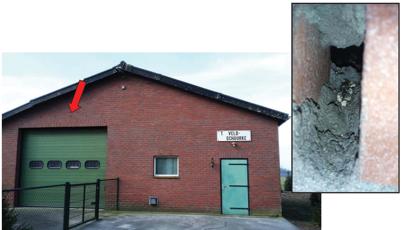
Figuur 11. In één van de open stootvoegen (aangeduid met rode pijl) werden uitwerpselen van (gewone) dwergvleermuis aangetroffen (zie detailfoto).
