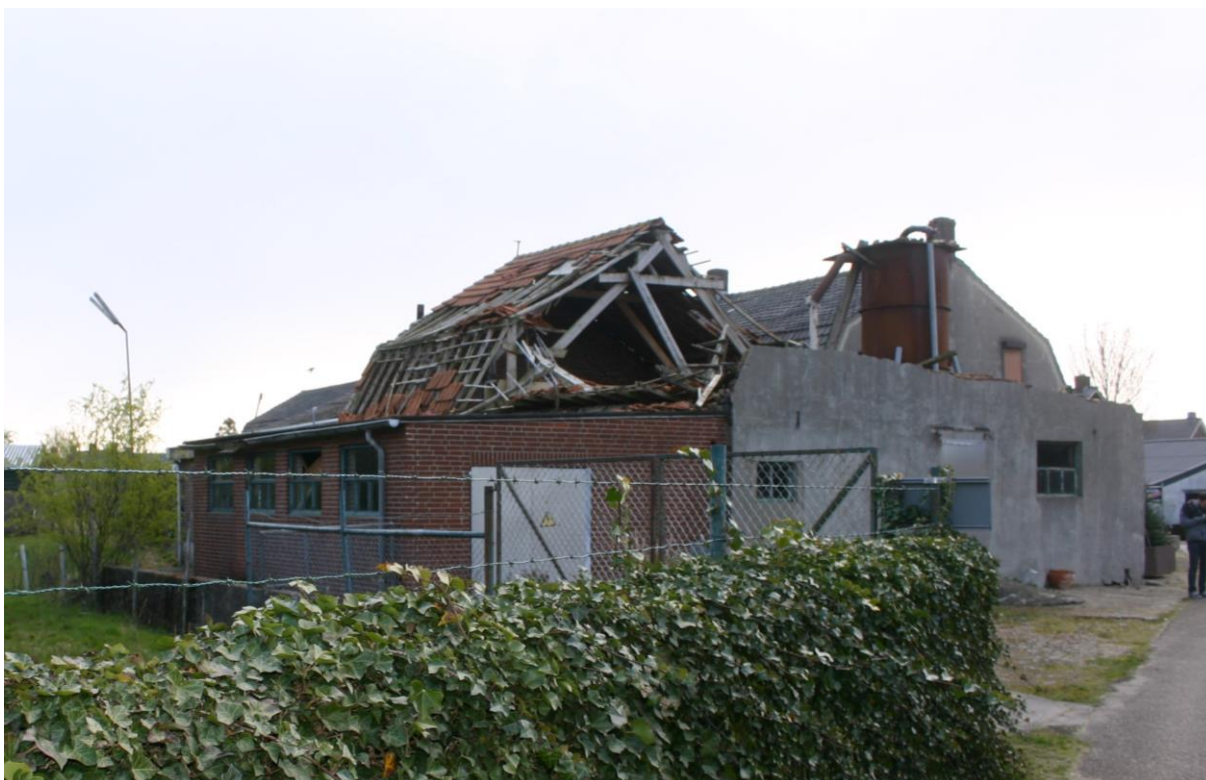
Figuur 4.1.3. Deels ingestort gebouw.
