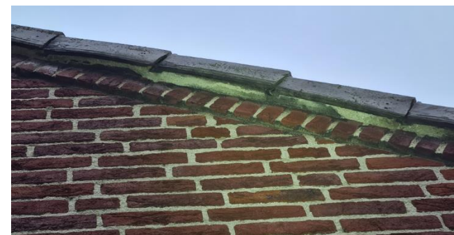
Figuur 9: Geen ingang dakpannen
