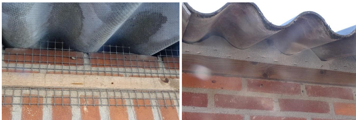
Afbeelding 10 en 11: Daken stallen afgesloten met gaas en vogelschroot. Bron: R.J.L. Bijvelds 29-03-2021
