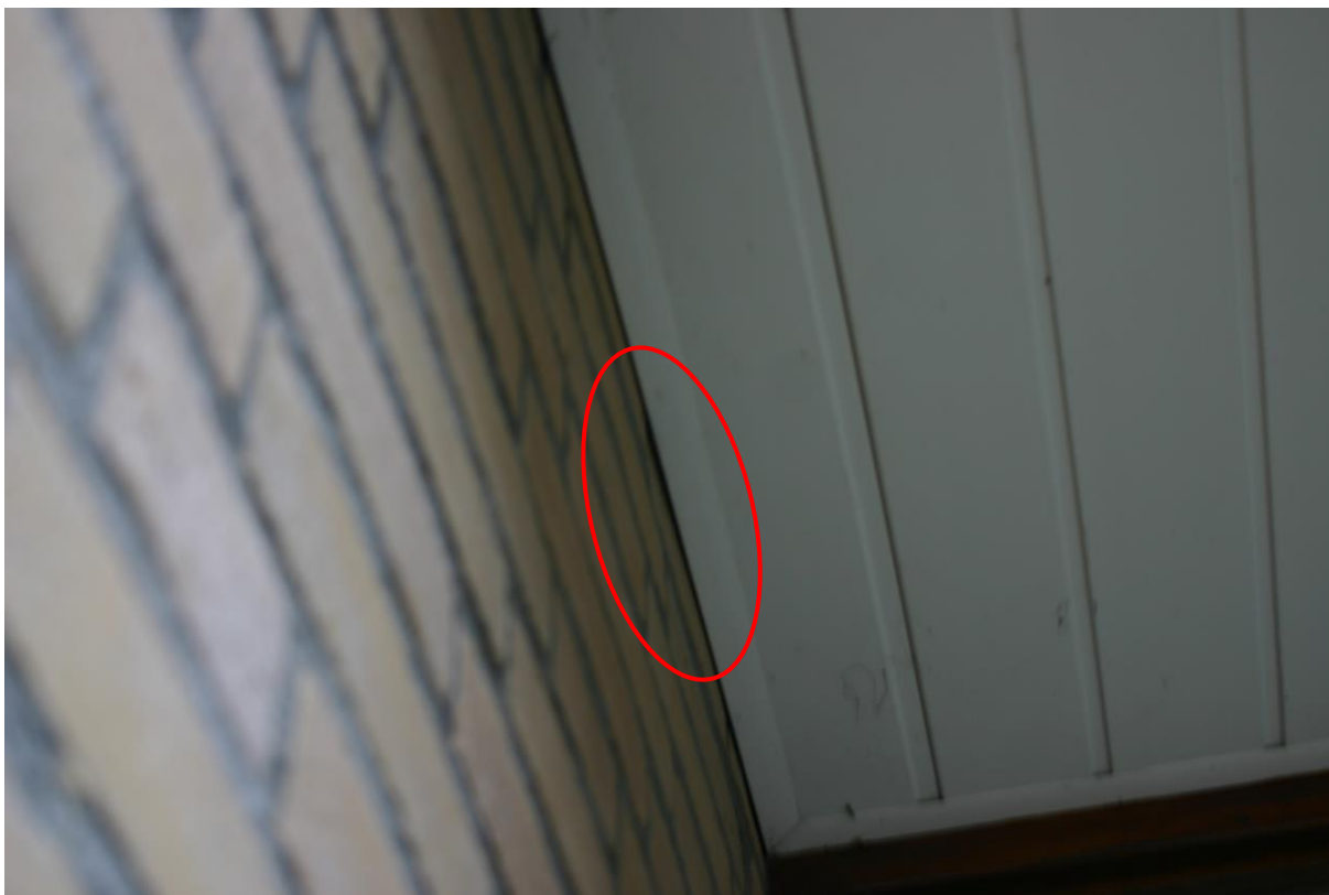
Figuur 4.4.3. Tussen de gevels en dakoverstekken bevinden zich op meerdere plaatsen kieren (rood omlijnd).
