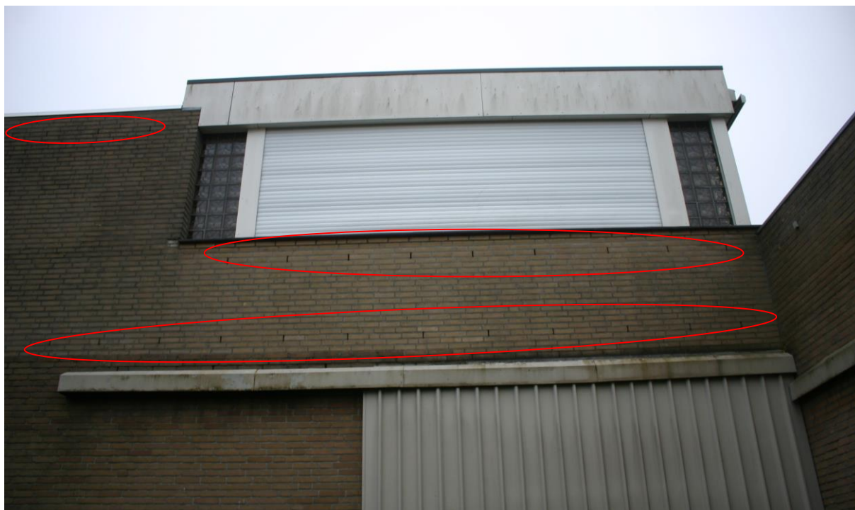
Figuur 4.4.1. Vanuit de binnenplaats zijn diverse open stootvoegen (rood omlijnd) te zien, op circa 4, 5 en 7 meter hoogte. Hierdoor kunnen vleermuizen de spouw binnen.
