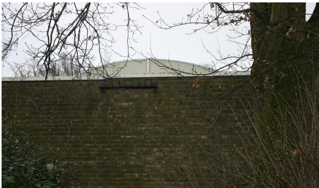
Figuur 4.4.2. In de westgevel van het zwembad zijn over de gehele lengte open stootvoegen aanwezig.
