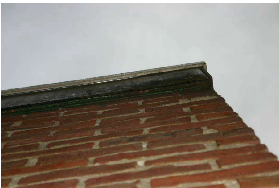
Figuur 4.2.4. Kierende daktrim en boeiboord, waardoor vleermuizen de achterliggende ruimte kunnen bereiken.
