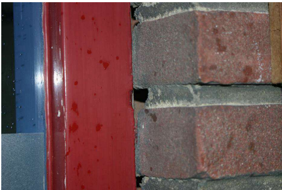
Figuur 4.2.3. Naast de raamkozijnen zijn meerdere openingen die vleermuizen toegang geven tot de spouw.
