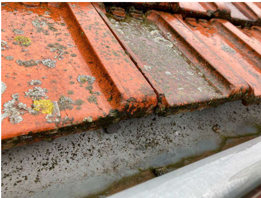
Figuur 4.2.1. Onder de onderste rij dakpannen is veel te weinig ruimte om huismussen toegang te geven tot de ruimte eronder.
