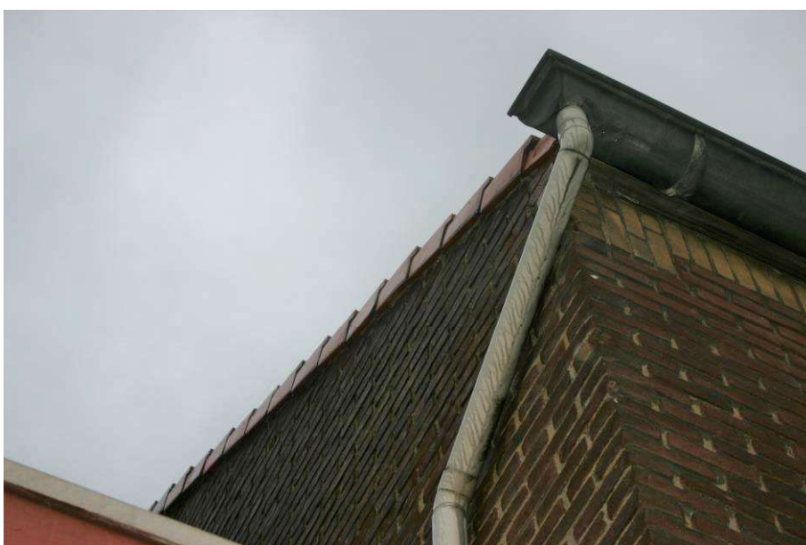
Figuur 4.2.2. De gevelpannen sluiten niet nauw aan op de gevel. Deze ruimte is te krap voor gierzwaluwen (en huismussen) maar kunnen wel vleermuizen toegang geven tot de spouw.
