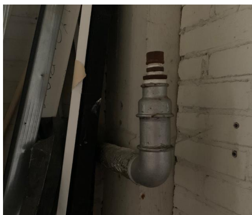
Afbeelding 2: Aangetroffen stalen olieleiding in kelder school.
