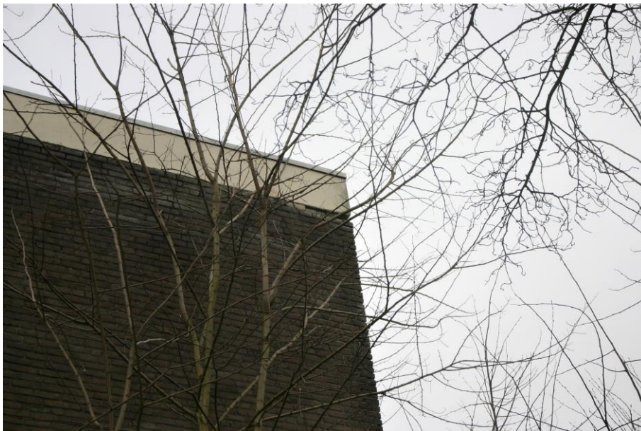
Figuur 4.4.2. Op de meest zuidelijke hoek van het hoofdgebouw ontbreken enkele bakstenen.
