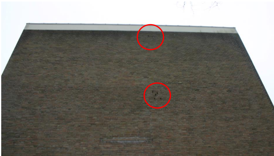
Figuur 4.4.1. In de bebouwing zijn op diverse plekken open stootvoegen aanwezig, op verschillende hoogtes (hier op circa 6 en 9 meter hoogte).
