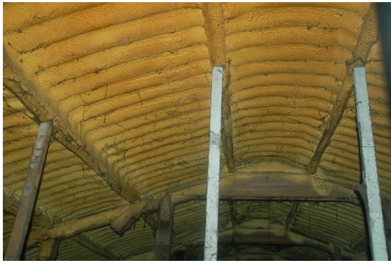
Luchtinlaat met directe isolatie op de golfplaten
