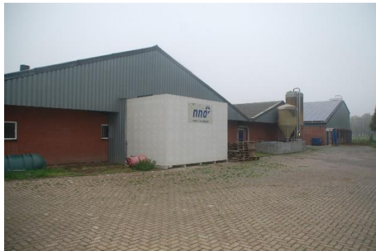
achterzijde met luchtwasser
