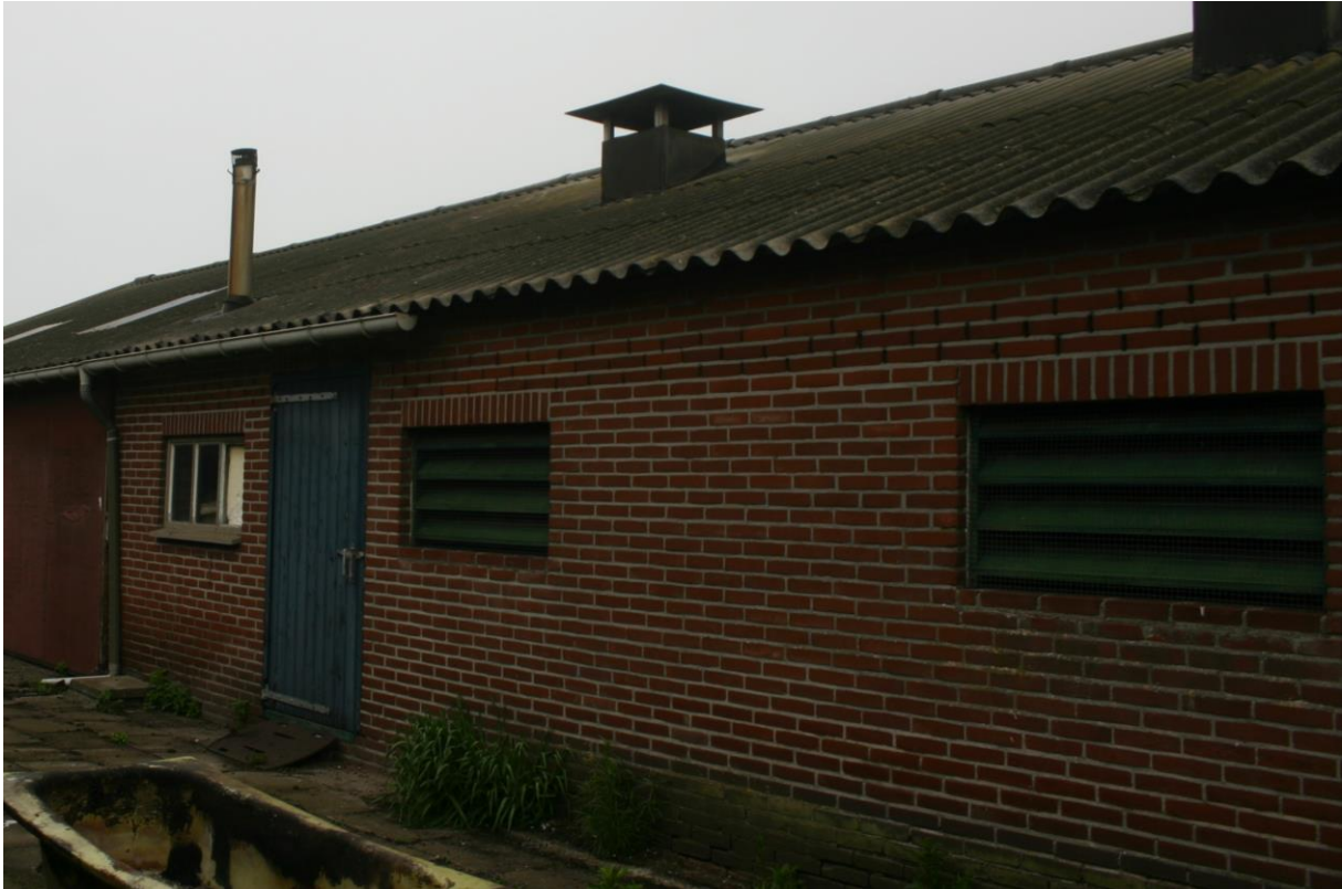
Figuur 4.2.1. Gebouw 1 heeft een lange rij van open stootvoegen in de buitenmuur als ventilatiesysteem. Dit maakt de spouw voor vleermuizen te tochtig als verblijf.
