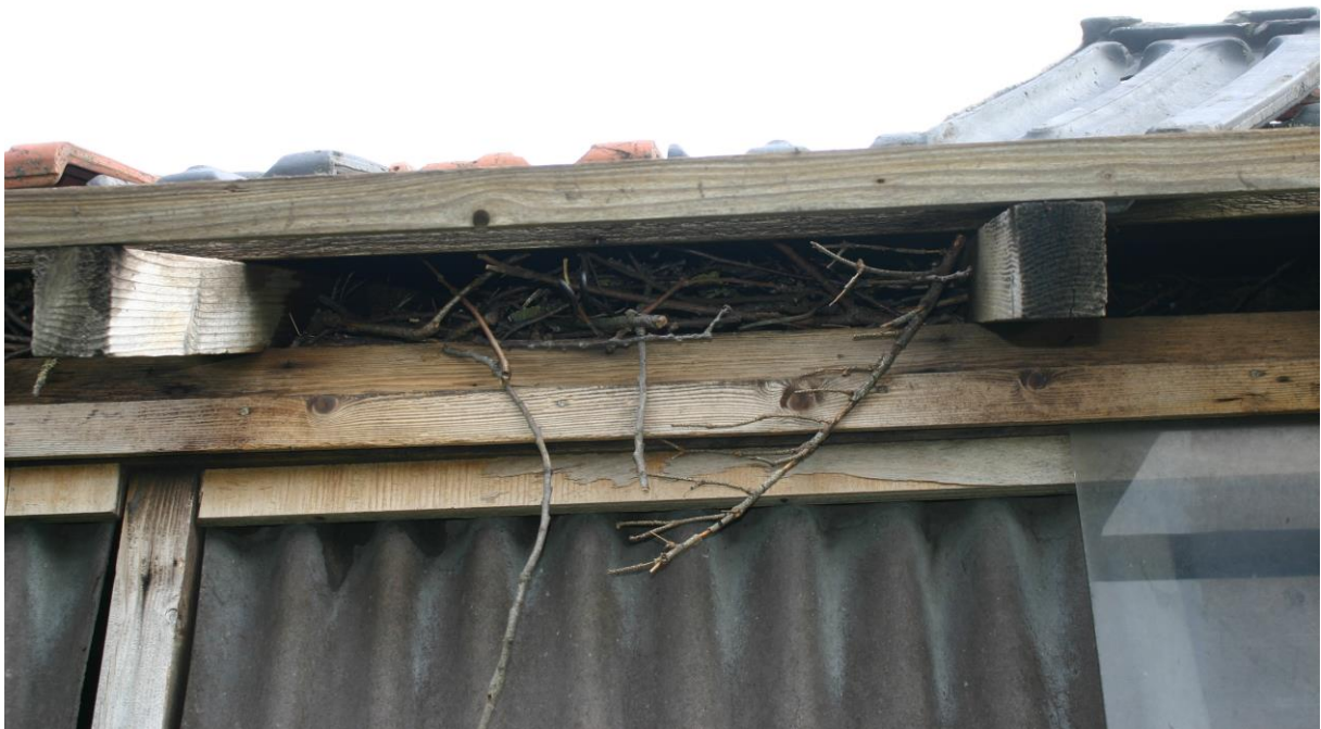
Figuur 4.2.2. Tussen de dakpannen en het dakbeschot van gebouw 4 zijn meerdere kauwennesten aanwezig.
