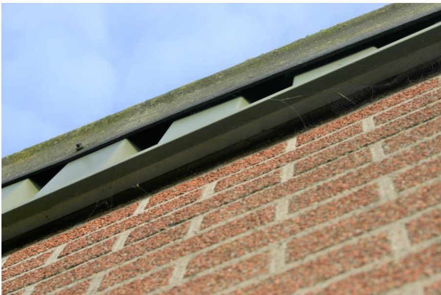
Figuur 4.2.4. De damwand afwerking op de kopse gevels sluit overal nauw aan, waardoor vleermuizen niet de bebouwing in kunnen kruipen.
