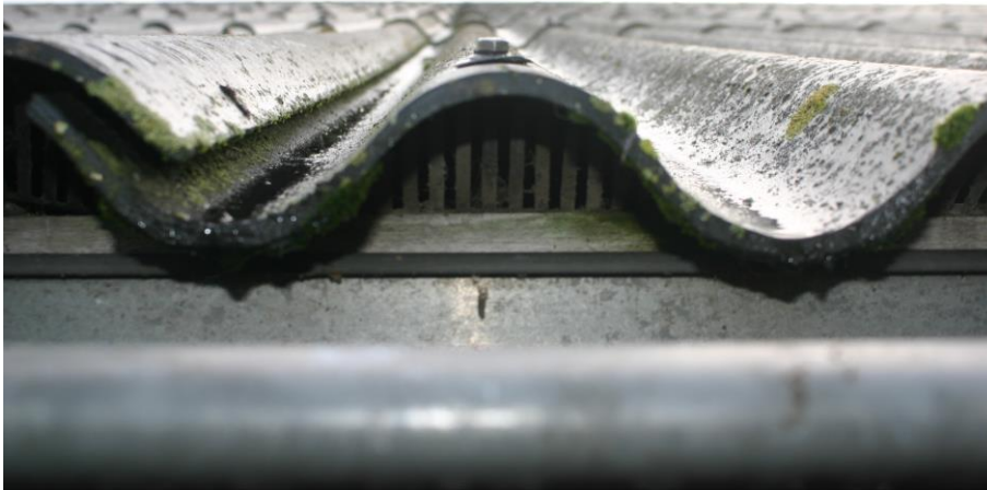
Figuur 4.2.1. Onder de ‘golven’ van golfplaten dak op de varkensstallen zijn geen openingen aanwezig.
