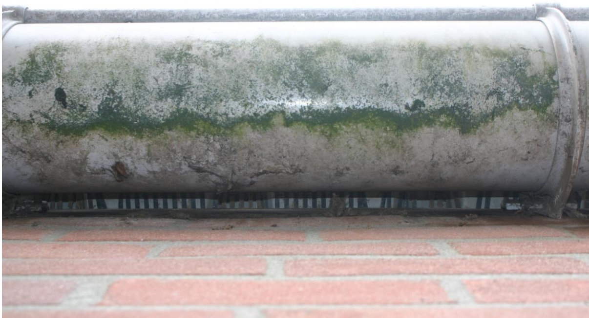
Figuur 4.2.5. Op de gevel ligt een spouwlat en onder het dak is vogelschroot aanwezig.
