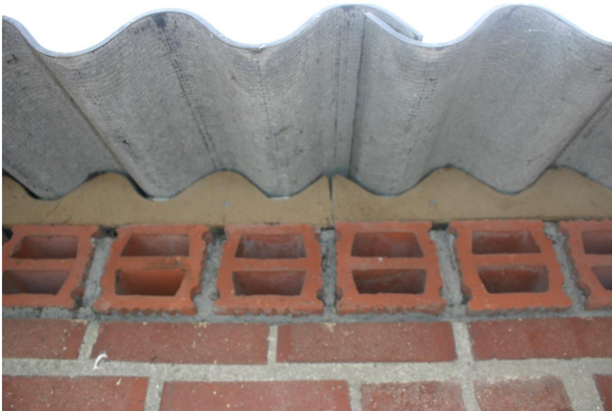
Figuur 4.2.1. Bevestigde vogelschroot onder de golfplaten daken.
