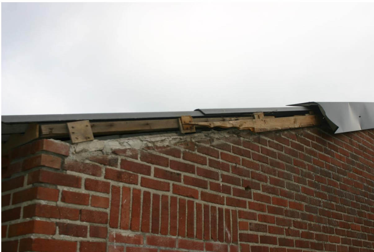
Figuur 4.2.3. Een deel van de windveer op de kopse gevel is beschadigd, waardoor de spouw toegankelijk is. Deze is echter te open en daardoor te tochtig voor vleermuizen.
