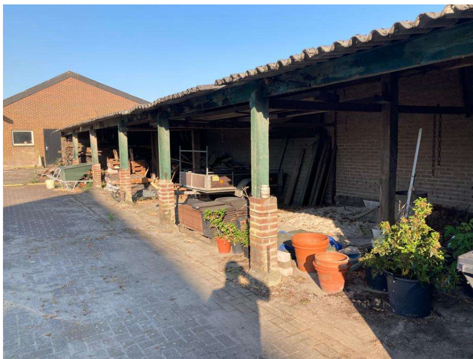
• Afbeelding 8: Overkapping aan bedrijfsgebouw voorzien van golfplaten zonder dakgoot
