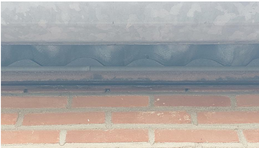
Figuur 4.2.2. Onder de golfplaten is vogelschroot aanwezig.
