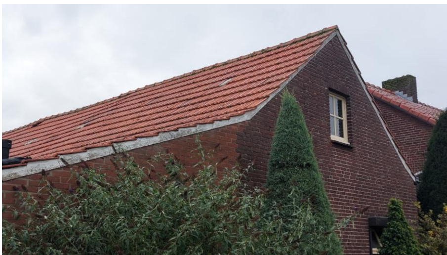
Figuur 4.2.6. De gevelpannen liggen in de specie; vogels en vleermuizen hebben hier geen toegang.
