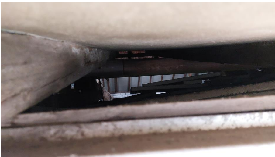
Figuur 4.2.4. Door een opening tussen het dakbeschot en de muurplaat staat de zolder in verbinding met de buitenruimte.
