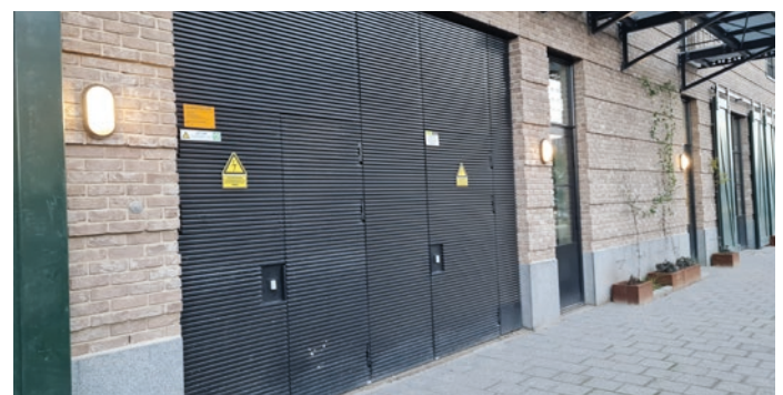
Installatiekasten inpandig in de rooilijn opgelost
