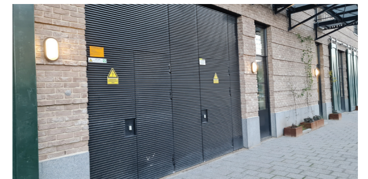
Installatiekasten inpandig in de rooilijn opgelost
