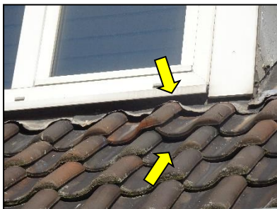
Figuur 17. Ruimte onder dakpannen en onder loodflappen, potentiële nestlocatie voor de huismus.
