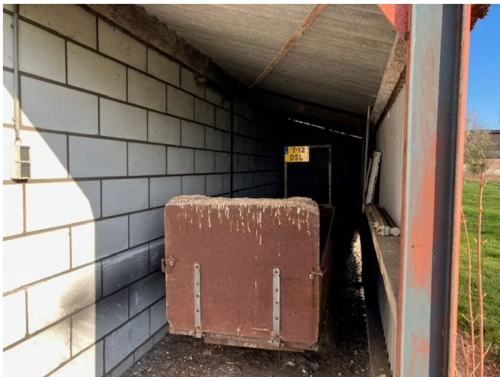
• Afbeelding 8: Bijgebouw aan de achterzijde met sporen van duiven
