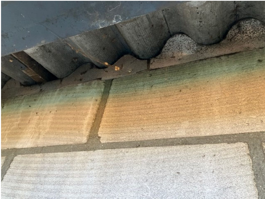
• Afbeelding 16: onderzijde dakaansluiting, dicht gezet met stalen vogelschroot
