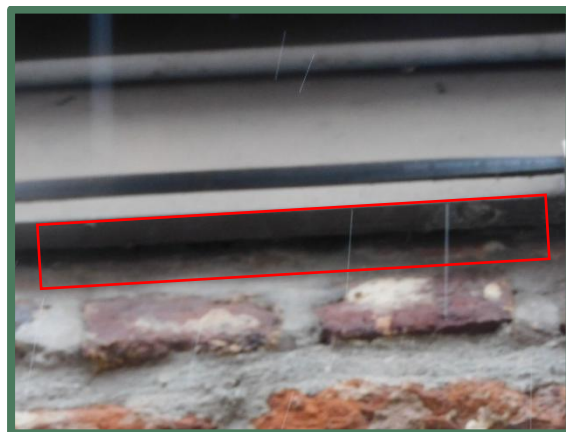
Foto 13: Kier achter houten plank onder dakgoot.
