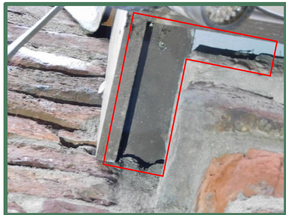
Foto 15: Opening bij houten plank.
