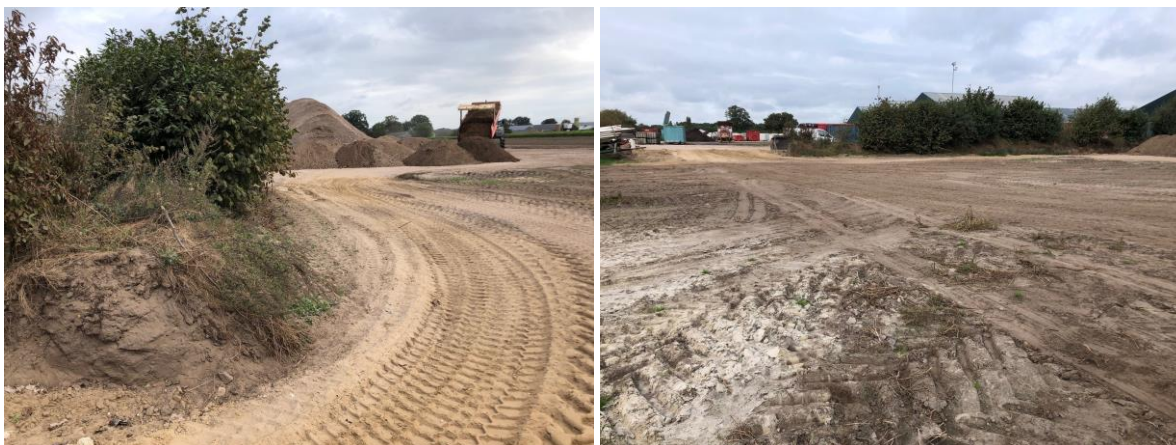
Figuur 4.1.2 Hier is recent struweelhaag verwijderd.
