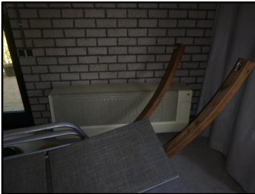
Gevelkachel is niet asbestverdacht.
