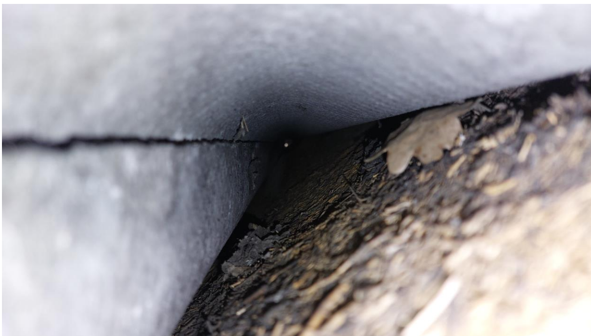
Figuur 4.4.2. Panlatten waarachter een nest kan worden gemaakt zijn afwezig.
