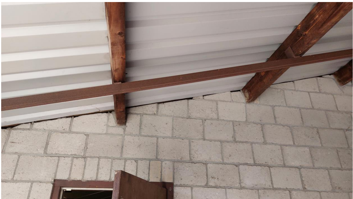
Figuur 4.4.4. Spleten tussen de gevel en het dak.
