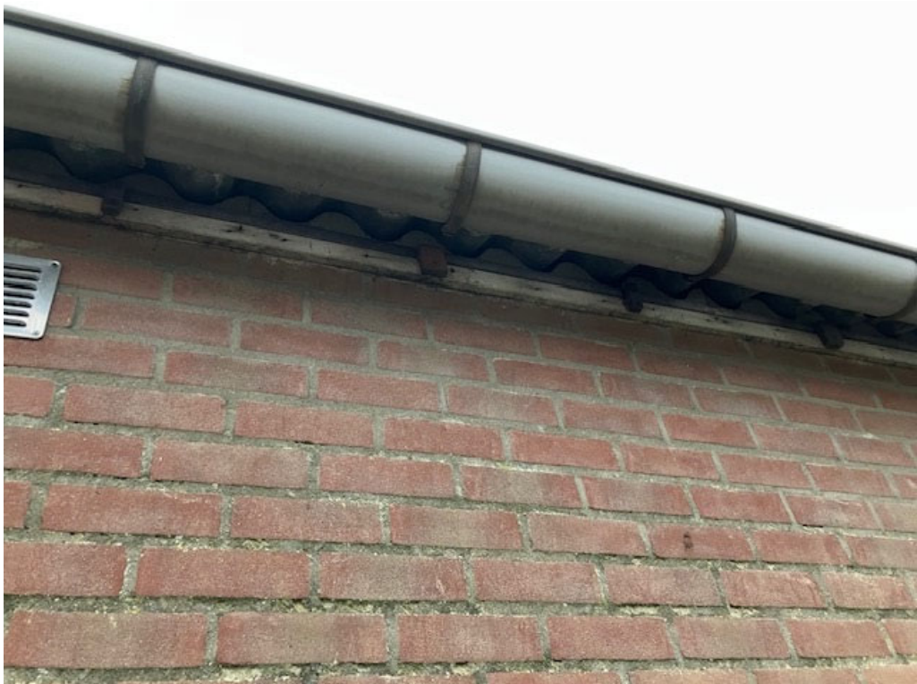
• Afbeelding 12: onderzijde dakaansluiting, dicht gezet met vogelschroot
