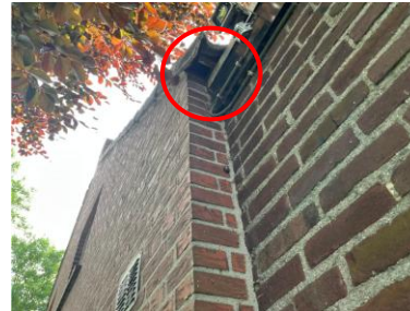
Figuur 27: Gat tussen het dak en de muur
