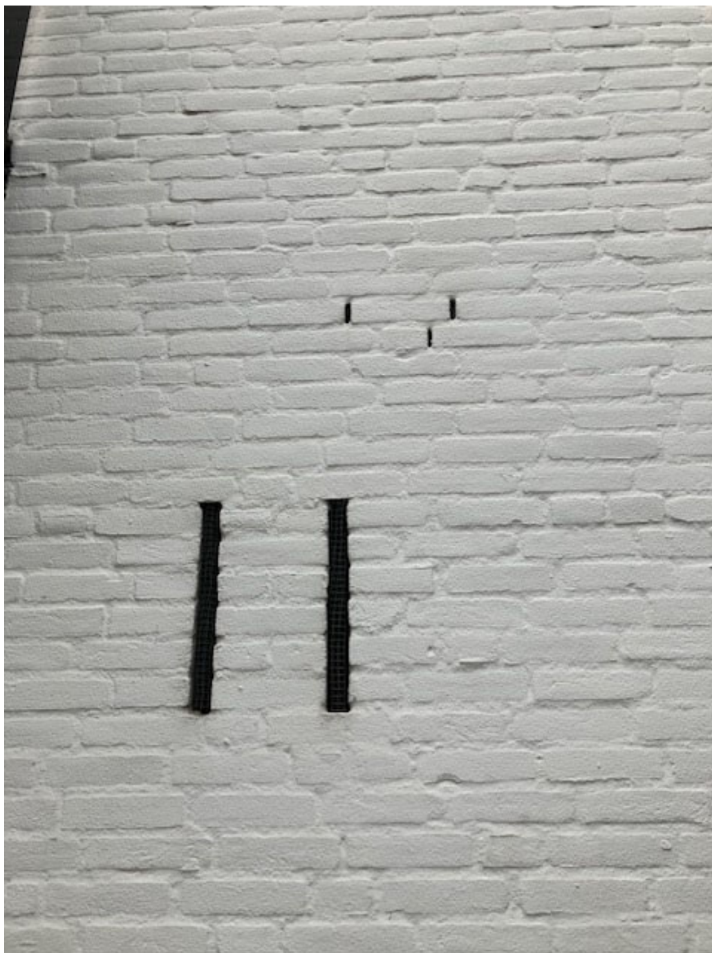
• Afbeelding 5: Luchtrooster van het toilet en dichte open stootvoegen
