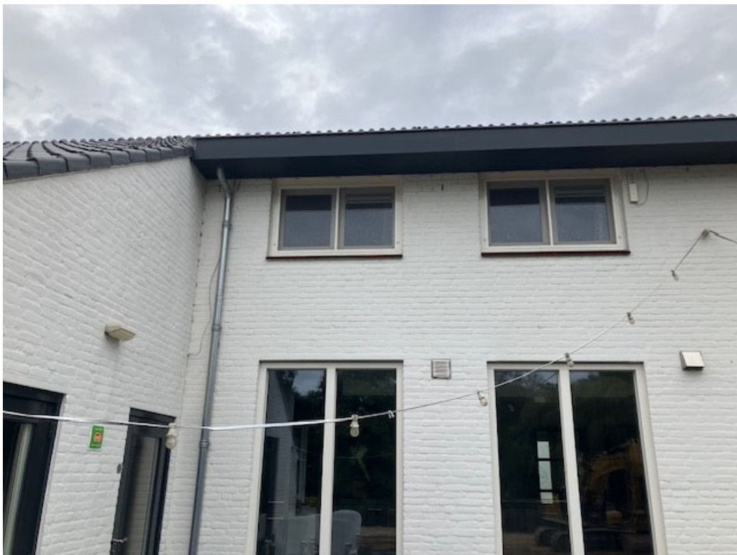
• Afbeelding 11: Stootvoegen zijn bovenin dicht gemaakt
