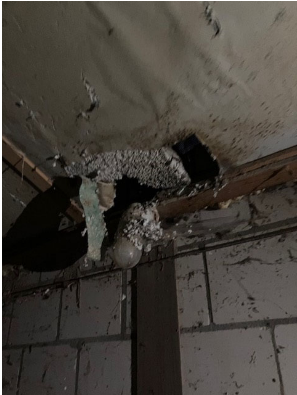
• Afbeelding 19: Ratten sporen in de pluimveestallen
