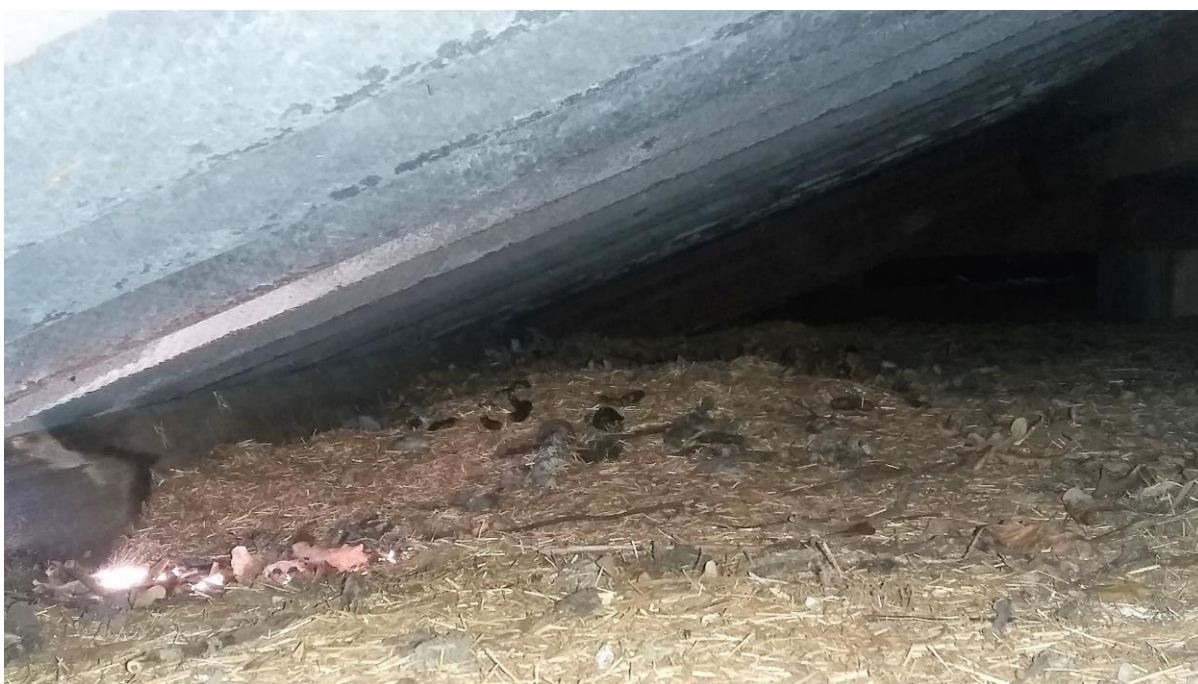
Figuur 9. Steenmarteruitwerpselen in één van de ruimten tussen het dak en de dakplaten.
