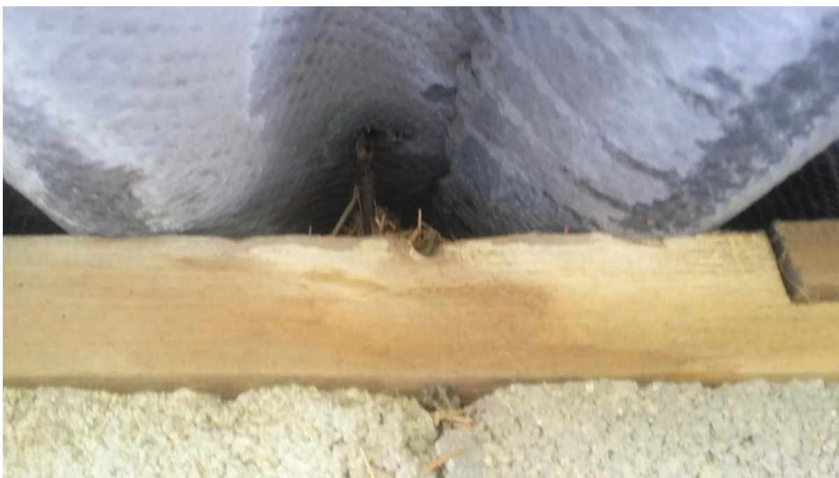
Figuur 18. Vogelnest (waarschijnlijk van winterkoning of roodborst) onder een van de golven van het golfplaten dak.
