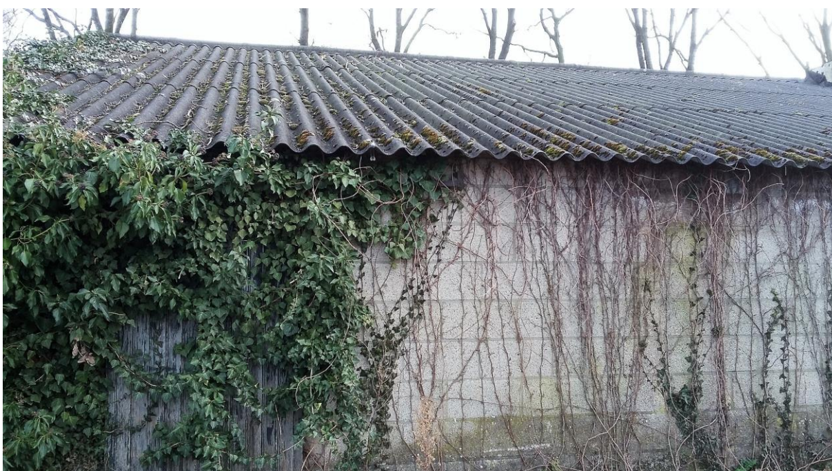
Figuur 11. De ruimten onder de golven van het golfplaten dak zijn deels dichtgegroeid met klimop.
